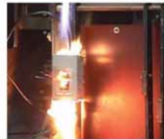
Los desconectores pirata pueden carecer de componentes de seguridad y fallar al dispararse o dispararse a tiempo para proteger el cableado en los hogares y edificios y prevenir un incendio.
